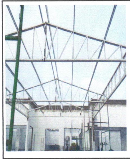
FOTO - 06 - TRAMA DE AÇO COMPOSTA POR TERÇAS PARA TELHADOS DE ATÉ 2 ÁGUAS PARA TELHA
